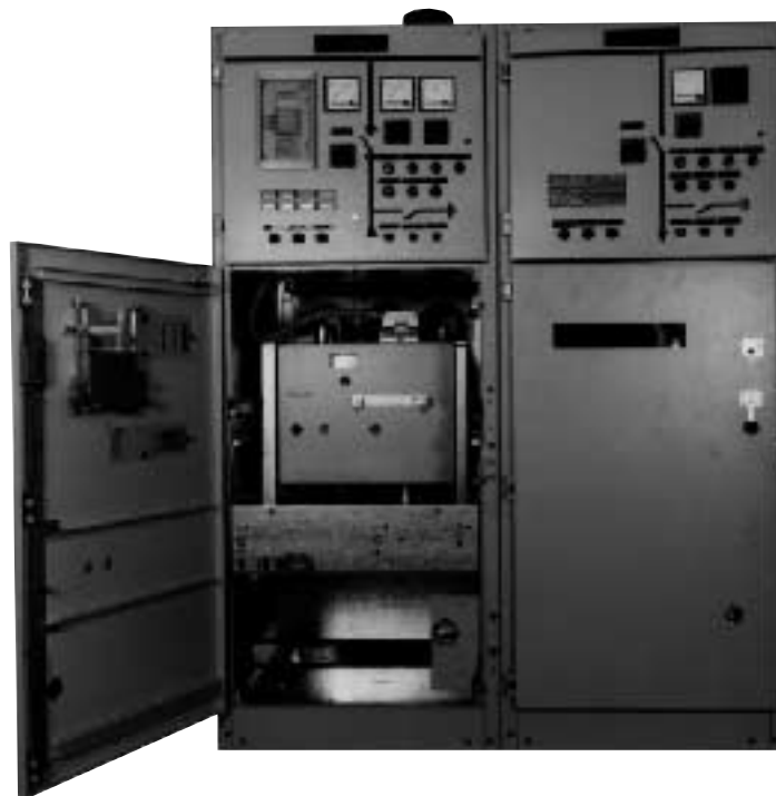
Vista frontal, con puerta abierta e interruptor en posición seccionado
